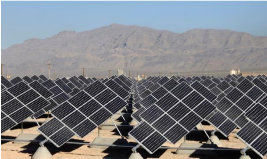
Rys. 42 Instalacja fotowoltaiczna Nellis AFB USA 118
