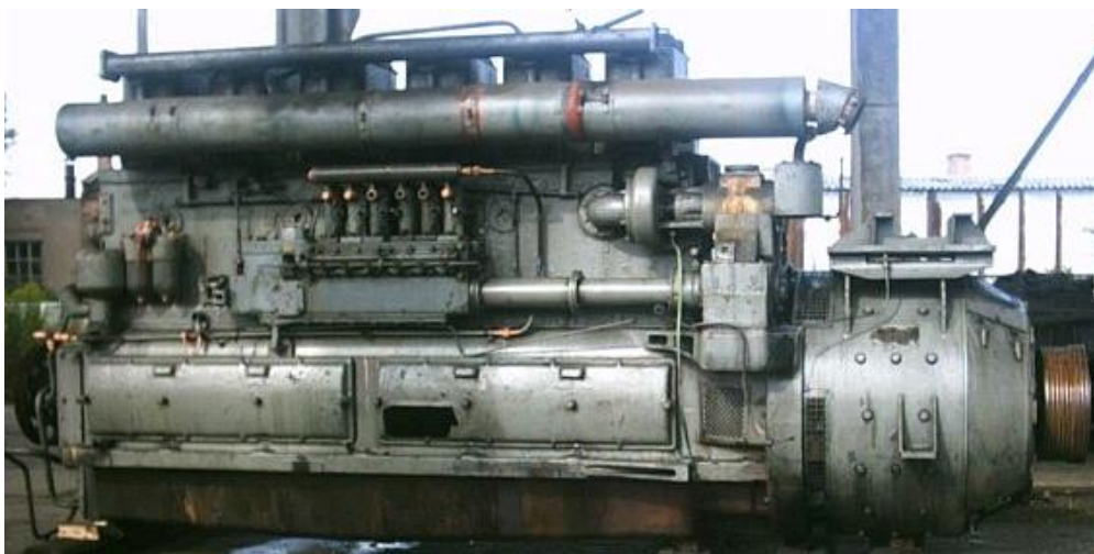
Rys. 6.2. Widok na zespół prądnicowy z silnikiem typu PD1M (przed modernizacją) [53]
