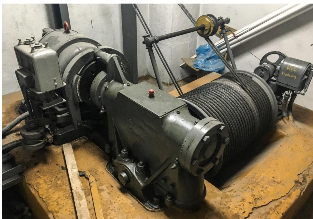
Ryc. 22. Poznań, oryginalny układ napędowy czynnego dźwigu osobowo-towarowego z 1938 r., z widoczną wciągarką bębnową, numer katalogowy urządzenia D45. Fot. Autorki.
