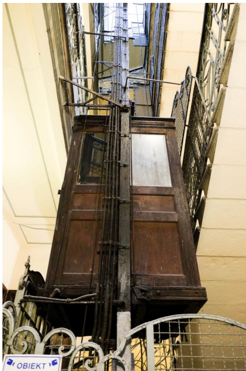
Ryc. 11. Kraków, nieczynny dźwig osobowy z 1912 r., numer katalogowy urządzenia D37. Fot. Autorki.
