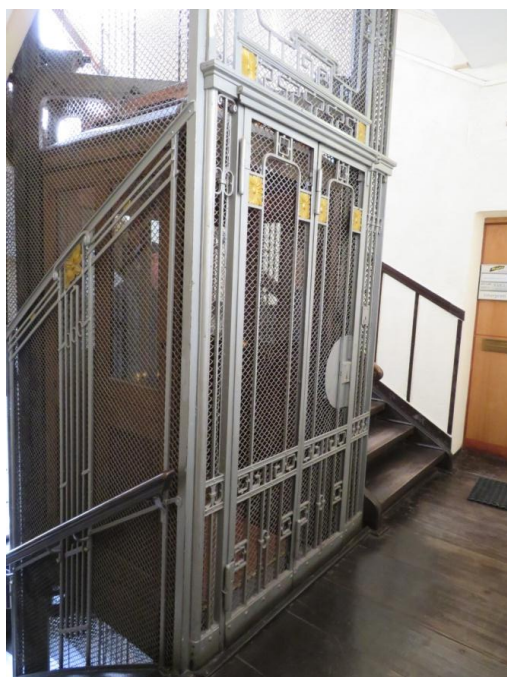
Ryc. 12. Poznań, czynny dźwig osobowy z 1910 r., numer katalogowy urządzenia D54. Fot. Autorki.
