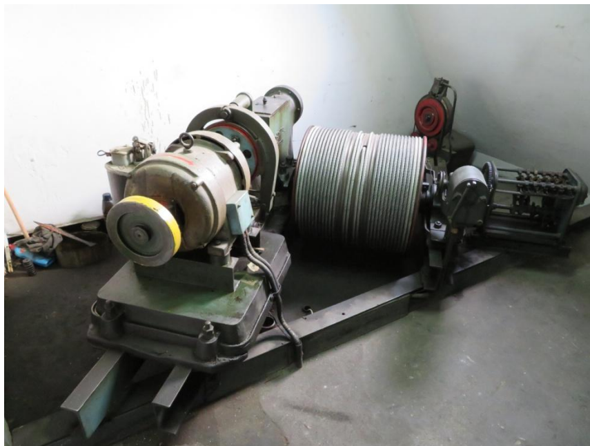
Ryc. 13. Poznań, oryginalny układ napędowy czynnego dźwigu osobowego z 1910 r., z widoczną wciągarką bębnową, numer katalogowy urządzenia D54. Fot. Autorki.
