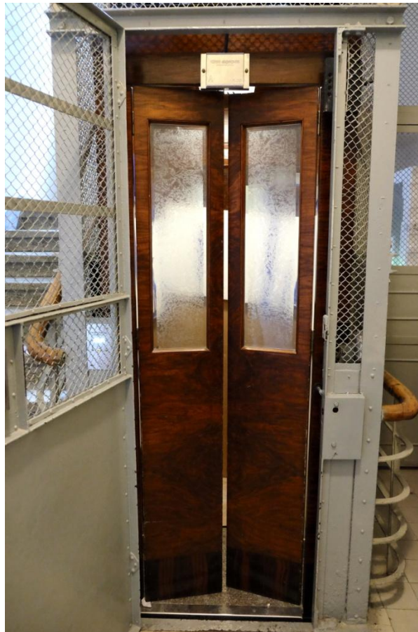
Ryc. 15. Gdynia, zachowany, czynny dźwig osobowy z napędem elektrycznym z 1936 r. (zachowana oryginalna wciągarka cierna), produkcji firmy Roman Groniowski Spółka Akcyjna, nieujęty w katalogu. Fot. Autorki.
