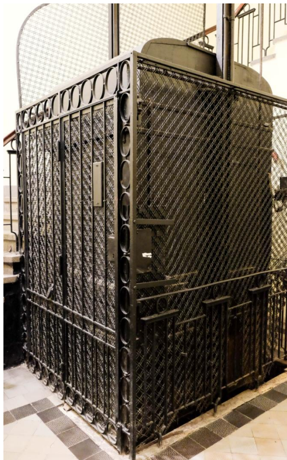
Ryc. 14. Kraków, nieczynny dźwig osobowy z 1913 r., numer katalogowy urządzenia D23. Fot. Autorki.
