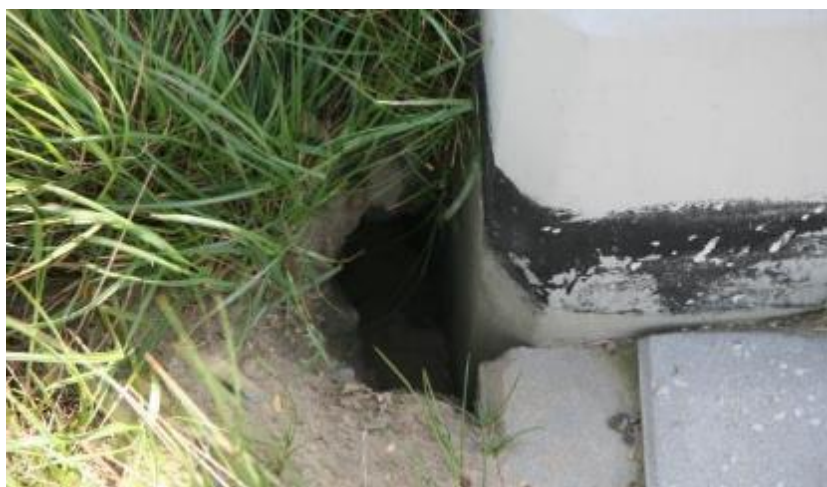
Rys. 14.34 Uszkodzenia Pół-zintegrowanego wiaduktu drogowego WD101 na odcinku Komorniki – Nowy Tomyśl autostrady A2
