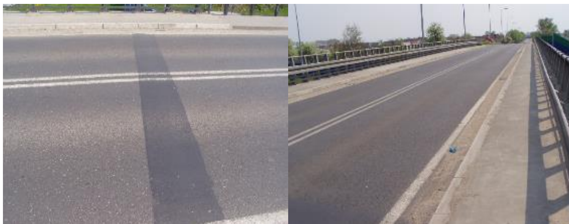
Rys. 14.8. Przykłady uszkodzeń wiaduktu Zintegrowanego WD41 na odcinku Września – Konin autostrady A2 w roku 2006
