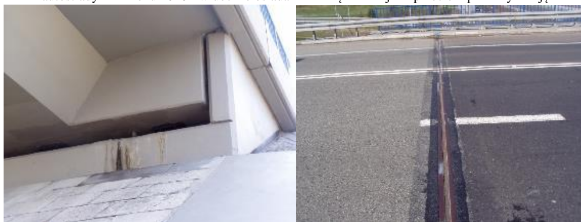
Rys. 14.17 Przykłady uszkodzeń Klasycznego wiaduktu drogowego WD77KL na odcinku Września – Konin autostrady A2 z roku 2006 - widoczne przecieki przez dylatację
