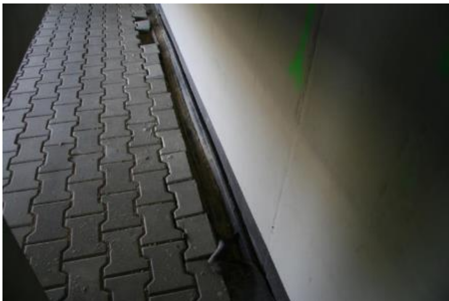
Rys. 14.35 Uszkodzenia Pół-zintegrowanego wiaduktu drogowego WD101 na odcinku Komorniki – Nowy Tomyśl autostrady A2
