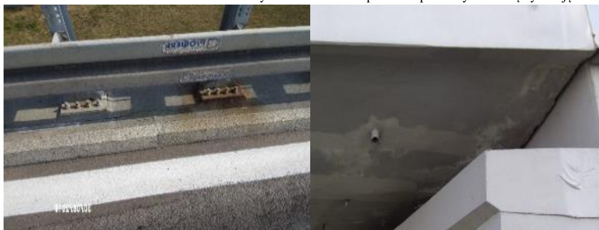
Rys. 14.16 Przykłady uszkodzeń Klasycznego wiaduktu drogowego WD66KL na odcinku Września – Konin autostrady A2 z roku 2018 - widoczne osiadanie krawężników jak i przecieki przez dylatację
