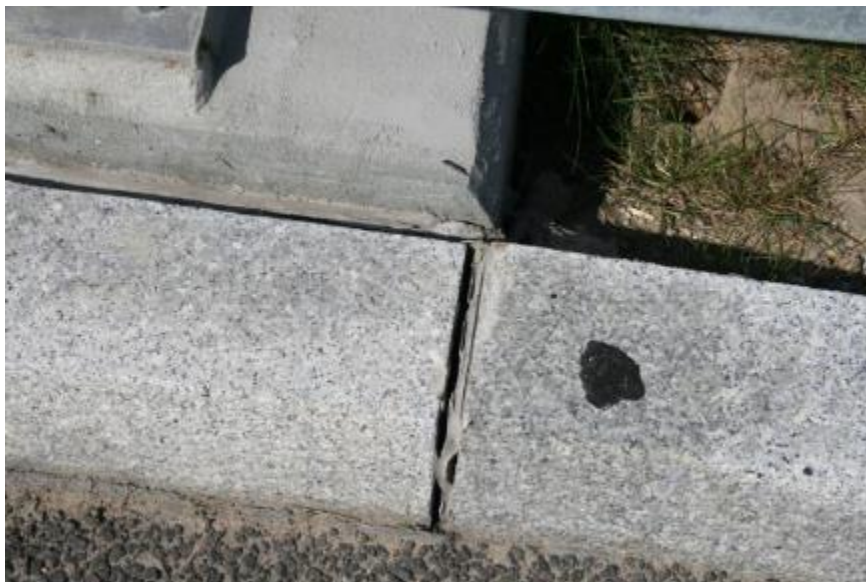
Rys. 14.33 Uszkodzenia Pół-zintegrowanych wiaduktów drogowych WD88 i WD101 na odcinku Komorniki – Nowy Tomyśl autostrady A2
