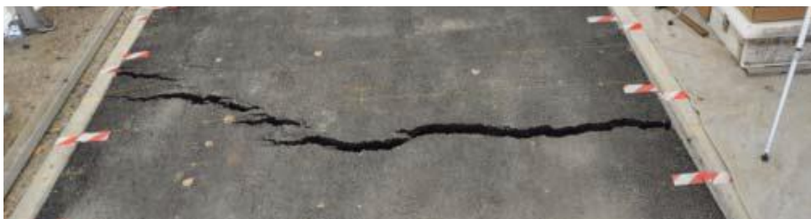
Rys. 3.3 Widok spękań nawierzchni przy przemieszczeniu płyty przejściowej równym 35 mm [38]
