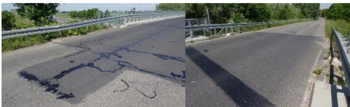
Rys. 14.10 Przykłady uszkodzeń Zintegrowanego wiaduktu drogowego WD64 na odcinku Września – Konin autostrady A2 w roku 2018
