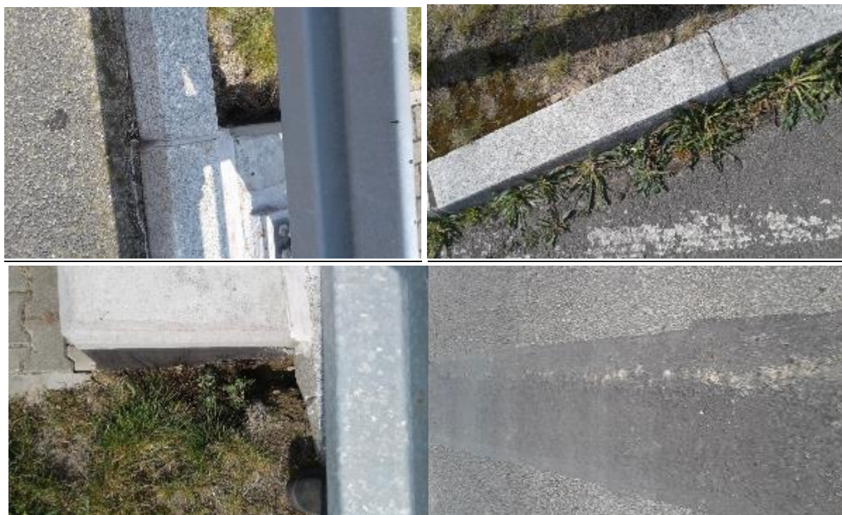
Rys. 14.22 Przykłady uszkodzeń Pół-zintegrowanego wiaduktu drogowego WD88 na odcinku Komorniki – Nowy Tomyśl autostrady A2 z roku 2019
