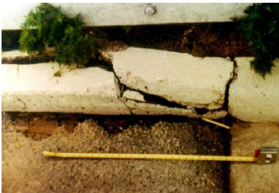
Rys. 5.8 Pęknięcia naroży i krawężników w okolicach końców Zintegrowanych i Pół-zintegrowanych obiektów inżynierskich [95]
