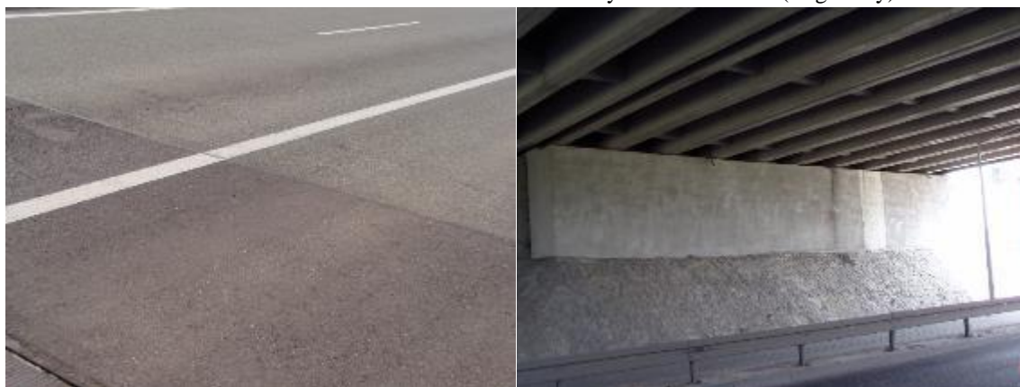
Rys. 14.13 Przykłady uszkodzeń Klasycznego wiaduktu autostradowego WA39KL na odcinku Września – Konin autostrady A2 z roku 2006 – konieczność wymiany nawierzchni w rejonie nad płytą przejściową, w tle widoczne przecieki przez urządzenie dylatacyjne
