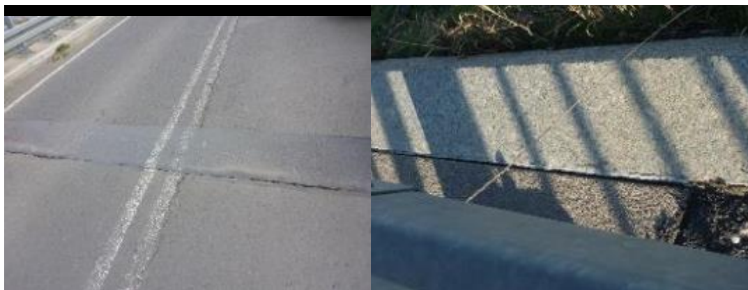
Rys. 14.26 Przykłady uszkodzeń Klasycznego wiaduktu drogowego WD31 na odcinku Września – Krzesiny autostrady A2 z roku 2015
