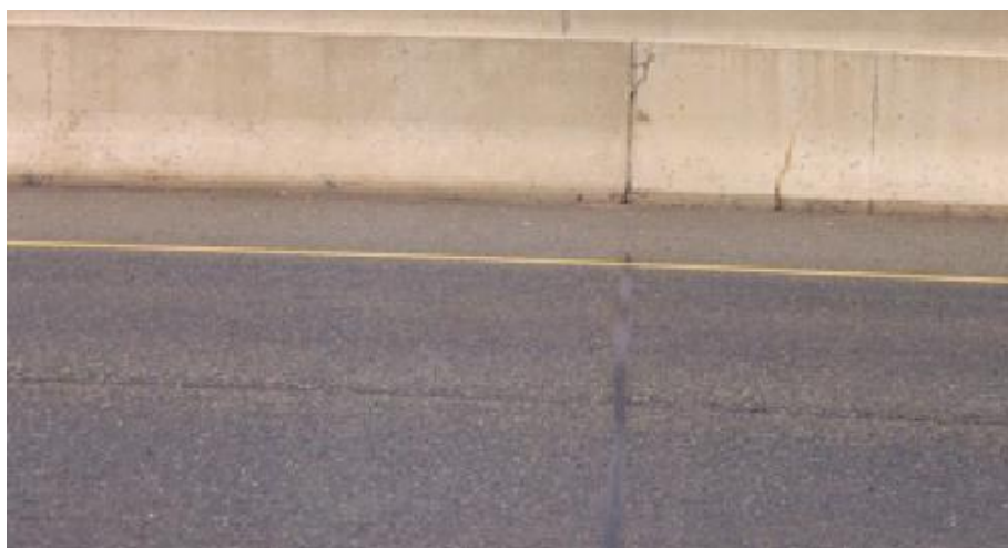
Rys. 5.7 Zarysowania barier nad podporą skrajną Zintegrowanych obiektów inżynierskich [95]
