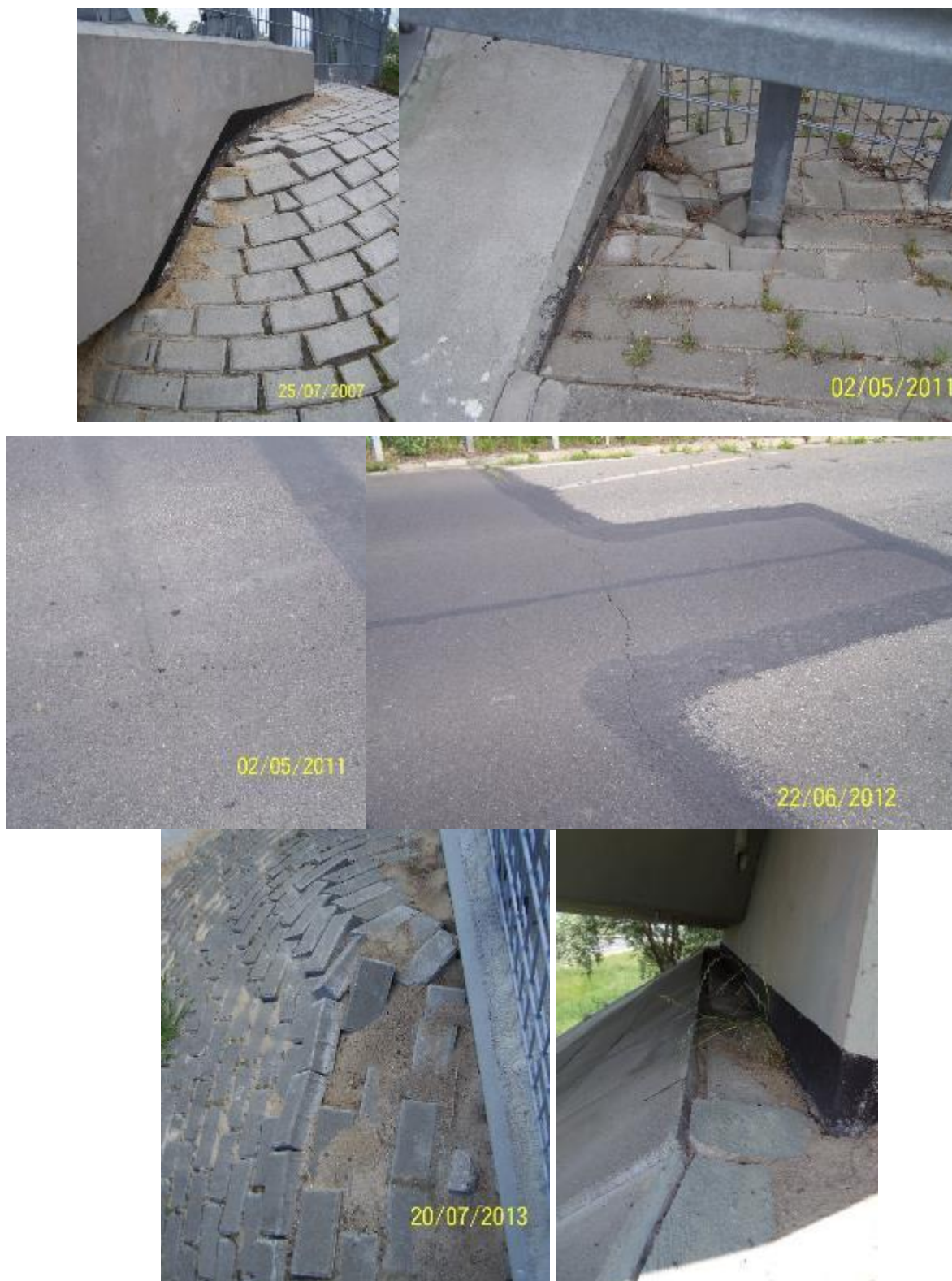
Rys. 14.11 Przykłady uszkodzeń Zintegrowanego wiaduktu drogowego WD64 na odcinku Września – Konin autostrady A2, od roku 2007 do roku 2018 po stronie południowej (zapadnięcie stożków, obrukowania, spękania w nawierzchni), które doprowadziły do wymycia zasyпки i uszkodzenia nawierzchni na jednym z dojazdów
