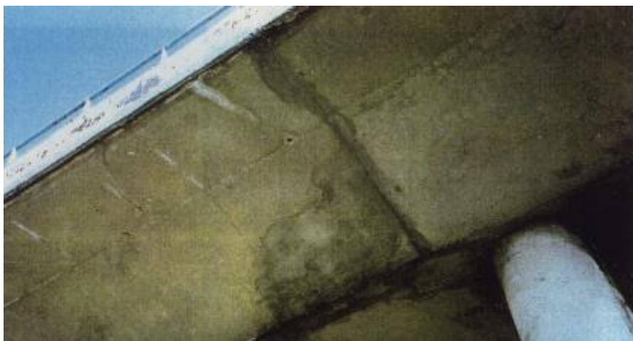
Rys. 14.3 Przykładowe uszkodzenia Zintegrowanego wiaduktu drogowego na odcinku Września – Konin autostrady A2 (zawilgocenia i rysy w miejscu połączenia słupów z płytą pomostową) [83]
