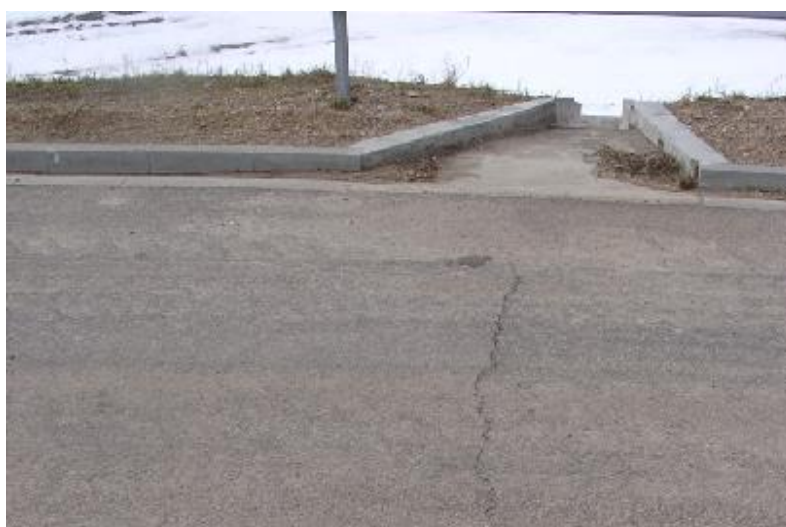
Rys. 14.32 Uszkodzenia Pół-zintegrowanego wiaduktu drogowego WD101 na odcinku Komorniki – Nowy Tomyśl autostrady A2
