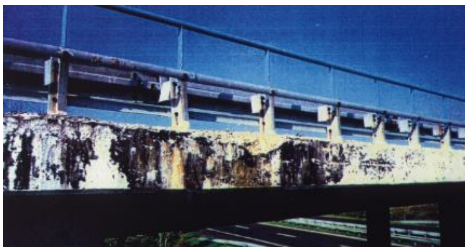
Rys. 14.4 Przykładowe uszkodzenia Zintegrowanego wiaduktu drogowego na odcinku Września – Konin autostrady A2 (korozja gzymsów) [83]
