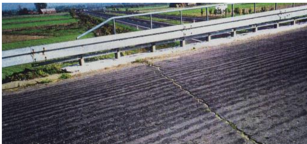
Rys. 5.1 Przykład uszkodzenia obiektów inżynierskich na odcinku autostrady A2 Września – Konin (spękania poprzeczne nawierzchni) [83]
