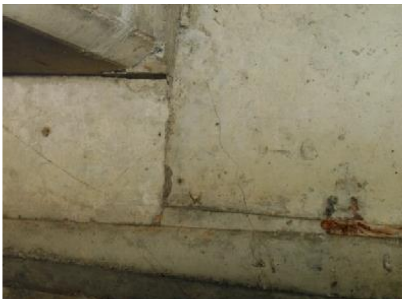
Rys. 5.9 Zarysowania skrzydełek i belek podłożyskowych Zintegrowanych i Pół-zintegrowanych obiektów inżynierskich [95]
