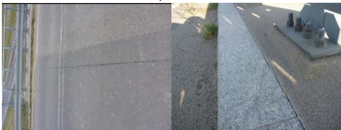
Rys. 14.27 Przykłady uszkodzeń Klasycznego wiaduktu drogowego WD33 na odcinku Września – Krzesiny autostrady A2 z roku 2015
