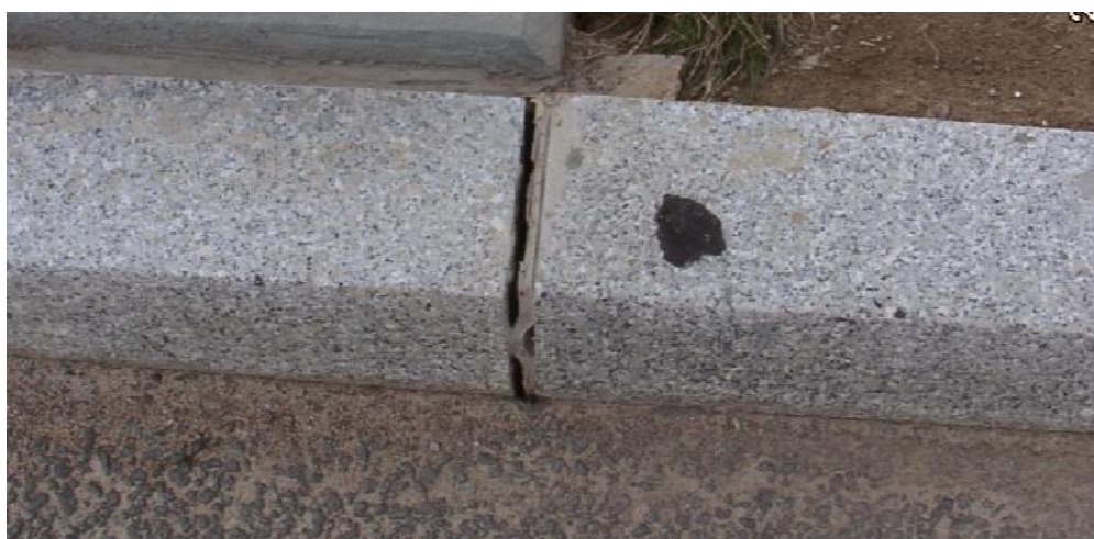
Rys. 14.31 Uszkodzenia Pół-zintegrowanych wiaduktów drogowych WD88 i WD101 na odcinku Komorniki – Nowy Tomyśl autostrady A2
