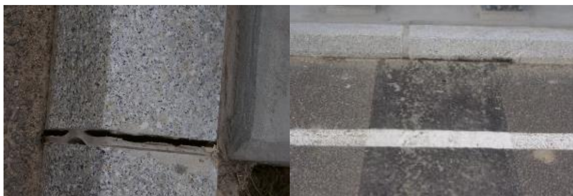
Rys. 14.23 Przykłady uszkodzeń Pół-zintegrowanego wiaduktu drogowego WD101 na odcinku Komorniki – Nowy Tomyśl autostrady A2 z roku 2005
