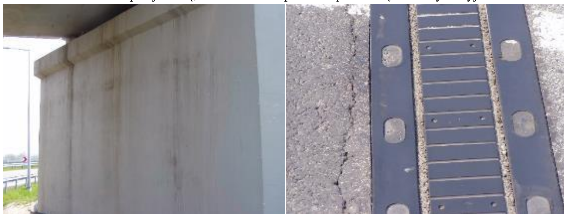
Rys. 14.14 Przykłady uszkodzeń Klasycznego wiaduktu drogowego WD66KL na odcinku Września – Konin autostrady A2 roku 2006
