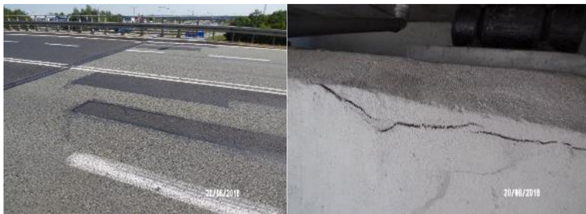
Rys. 14.18 Przykłady uszkodzeń Klasycznego wiaduktu drogowego WD77KL na odcinku Września – Konin autostrady A2 z roku 2018 – uszkodzenie nawierzchni na dojeździe i ławy podłożyskowej
