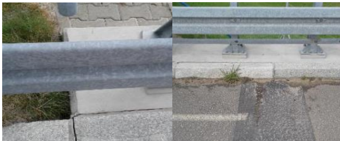
Rys. 14.24 Przykłady uszkodzeń Pół-zintegrowanego wiaduktu drogowego WD101 na odcinku Komorniki – Nowy Tomyśl autostrady A2 z roku 2019
