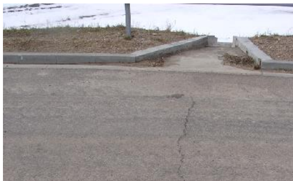
Rys. 5.4 Spękanie w nawierzchni na dojazdach do wiaduktu drogowego Pół-zintegrowanego WD101
