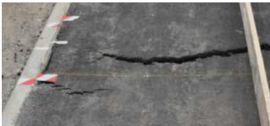
Rys. 3.4 Widok spękań nawierzchni przy przemieszczeniu płyty przejściowej równym 60 mm [38]
