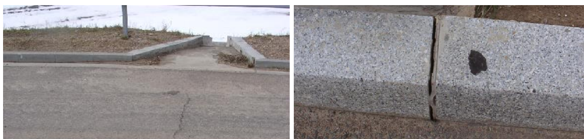
Rys. 5.5 Przykłady uszkodzenia wiaduktu Pół-zintegrowanego WD88
