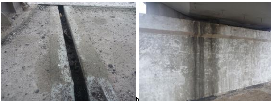
Rys. 14.15 Przykłady uszkodzeń Klasycznego wiaduktu drogowego WD66KL na odcinku Września – Konin autostrady A2 z roku 2014 - przecieki przez wymienioną dylatację
