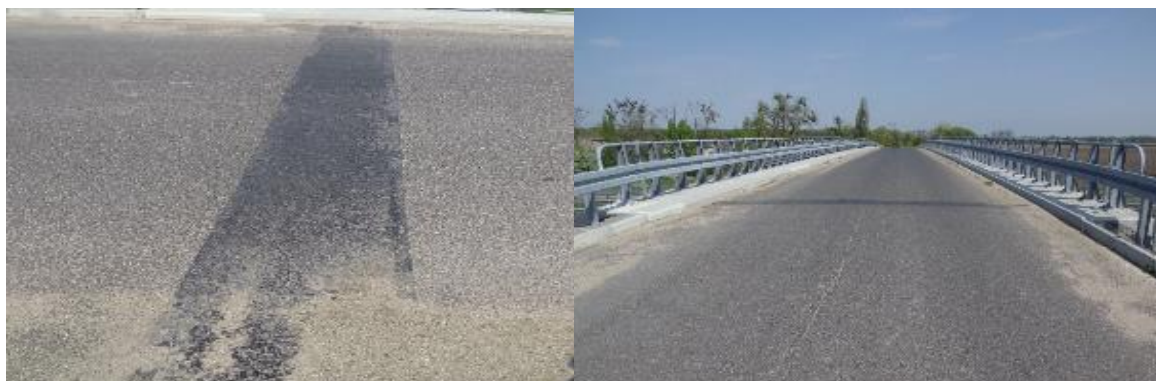
Rys. 14.9 Przykłady uszkodzeń Zintegrowanego wiaduktu drogowego WD46 na odcinku Września – Konin autostrady A2 w roku 2018
