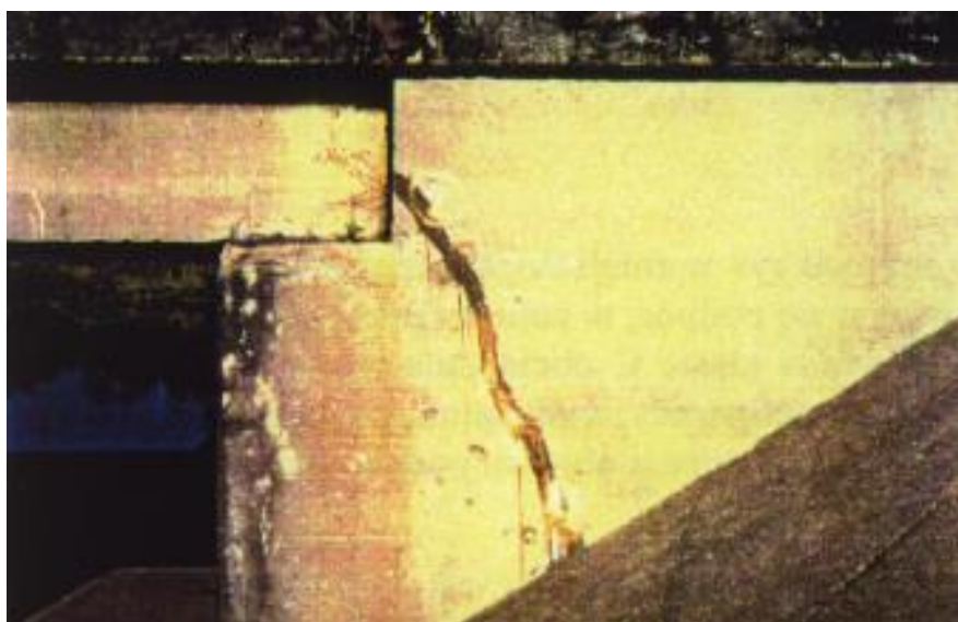
Rys. 14.5 Przykładowe uszkodzenia Zintegrowanego mostu autostradowego na odcinku Września – Konin autostrady A2 (rysy na połączeniu skrzydełek i korpusu) [83]
