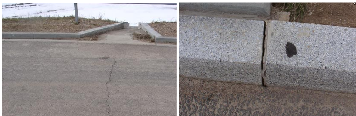
Rys. 14.21 Przykłady uszkodzeń Pół-zintegrowanego wiaduktu drogowego WD88 na odcinku Komorniki – Nowy Tomyśl autostrady A2 z roku 2005
