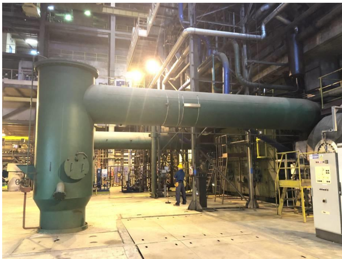
Rysunek 4.4 – Rurociągi wylotowe wody chłodzącej z kondensatora turbiny nr 1 w Elektrociepłowni Kraków
