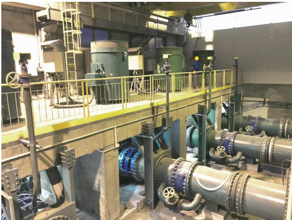
Rysunek 4.5 – Widok na pompy wody chłodzącej w Elektrociepłowni Kraków
