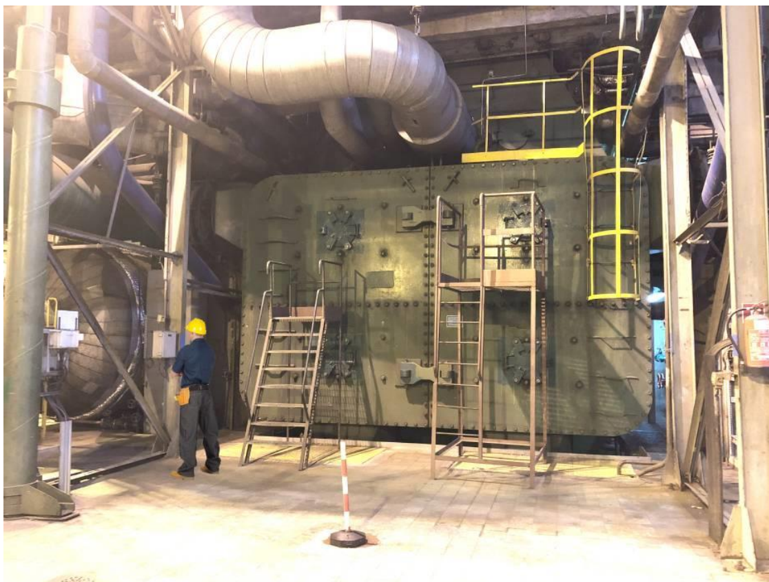
Rysunek 4.3 – Widok na kondensator turbiny nr 1 w Elektrociepłowni Kraków
